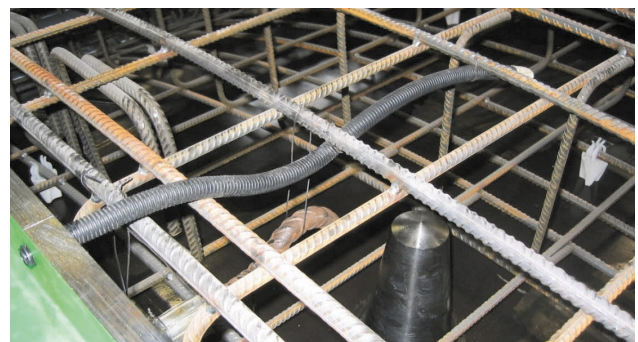
Abbildung 19 Injektionsschläuche zur nachträglichen Fugenabdichtung
